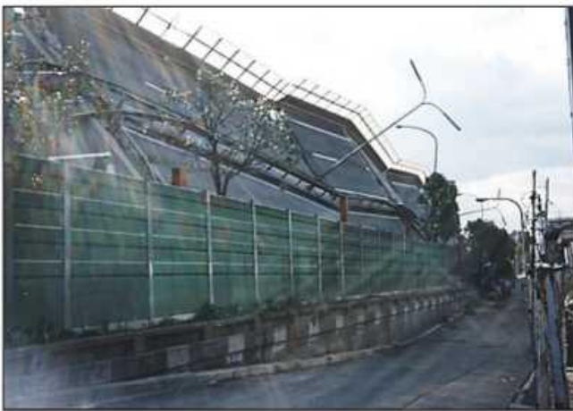
(気象庁撮影：阪神高速神戸線 神戸市東灘区)
