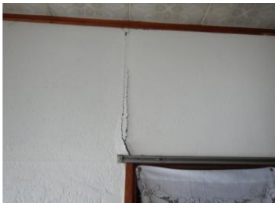
写真 1 民家の壁の亀裂（八戸市湊町）
