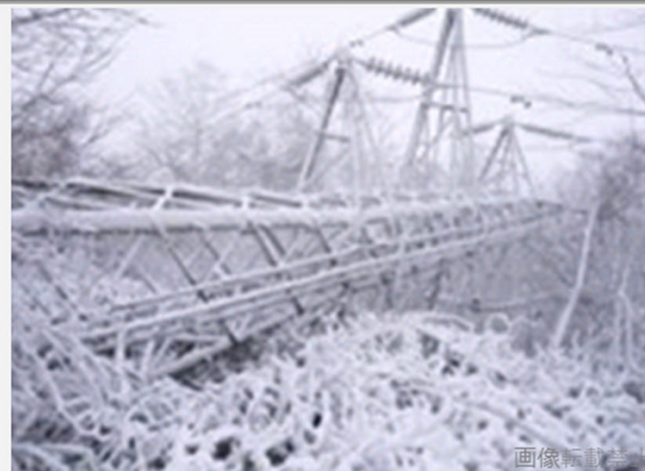
暴風で倒壊した高圧送電線の鉄塔 27日登別市（北海道電力提供資料）
