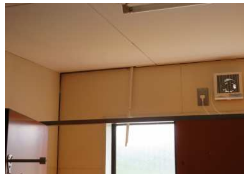
写真4 2階天井板のずれ
