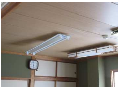
写真3 2階蛍光灯の剥がれ
