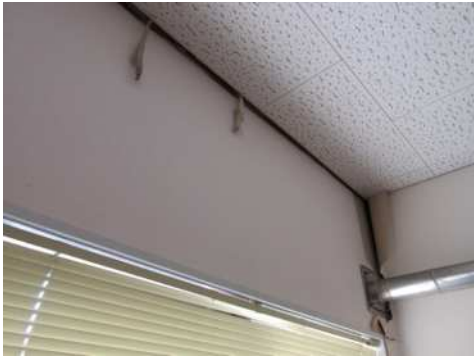
写真1 2階天井板のずれ
