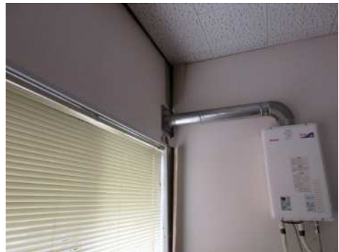
写真2 2階湯沸器のずれ
