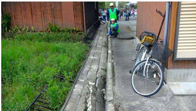
写真4 大江地区民家のブロック塀の 倒壊
