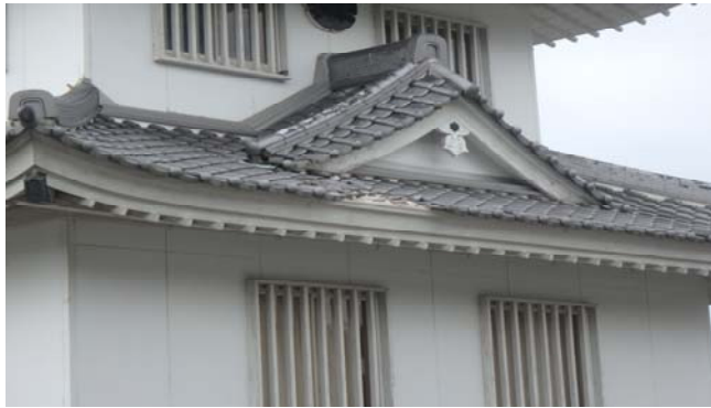
写真2 日野江の里天守閣タワー屋根 瓦の一部落下
