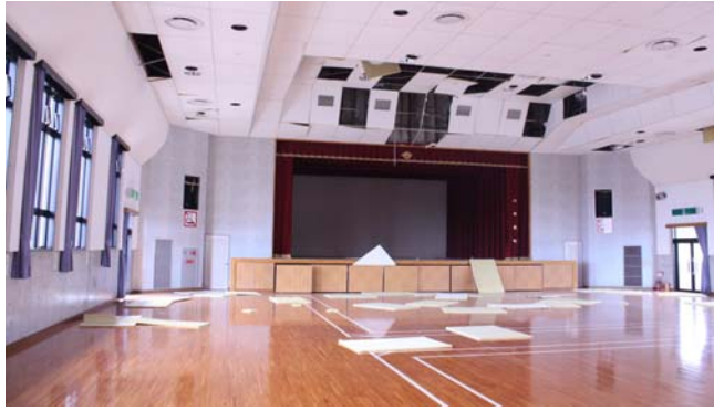
写真1 ピロティ文化センターの天井 パネルの一部落下 (写真提供：南島原市)
