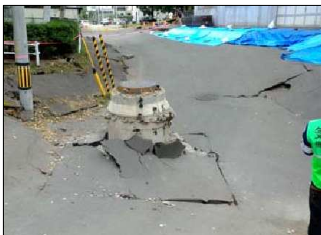
写真 1 マンホール周辺の道路の陥没（札幌清田区平岡地区） （平成 30 年北海道胆振東部地震現地調査報告より）
