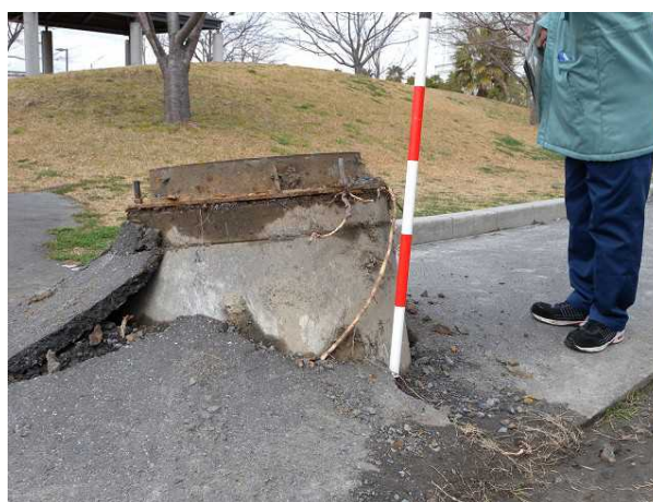
液状化の様子（千葉県浦安市）
