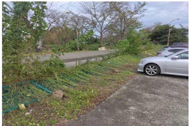
④ フェンスが倒れた駐車場 (西北西方向から撮影)
