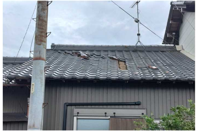
② 瓦がめくれた住家 (北方向から撮影)
