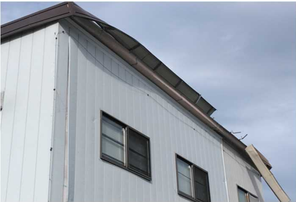
③ 屋根が飛散した鉄骨系プレハブ事務所 (南西方向から撮影)
