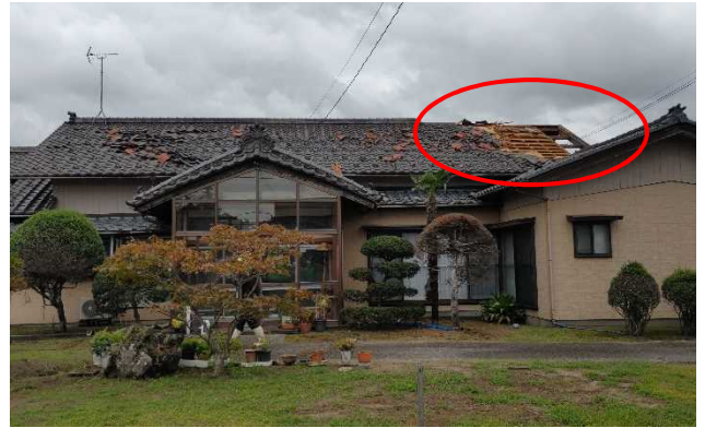
②野地板が飛散した住家 (北西方向から撮影)
