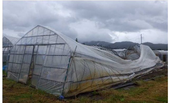
④パイプハウスの鋼管の変形 (西方向から撮影)
