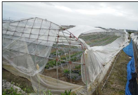
②変形したパイプハウス（南西から撮影）
