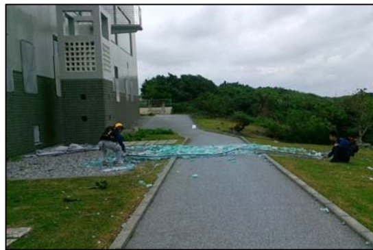
②-1 窓ガラスの破損(南から撮影)
