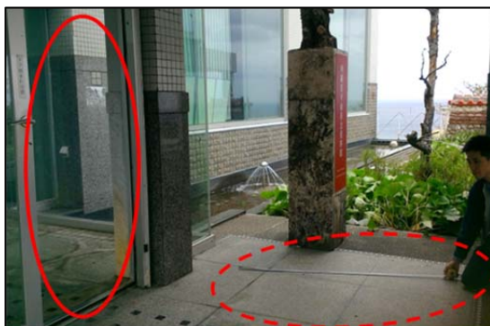
②-2 出入口ドアの破損 (南西から撮影)
