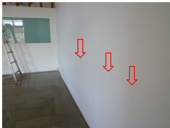
写真 6 : 建物浸水痕跡 (矢印の位置)
