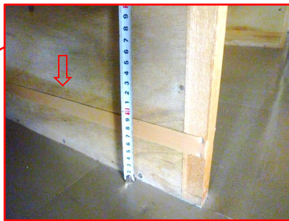
写真 2 : 浸水痕跡 (矢印の位置)
