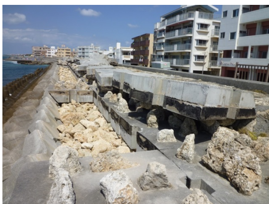
写真 5 : 高波により損壊した堤防
