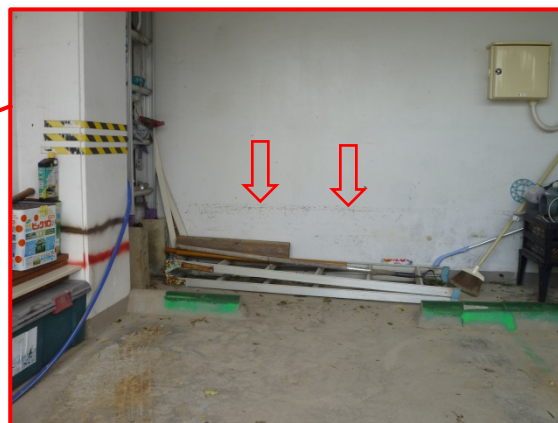
写真 4 : 浸水痕跡 (矢印の位置)
