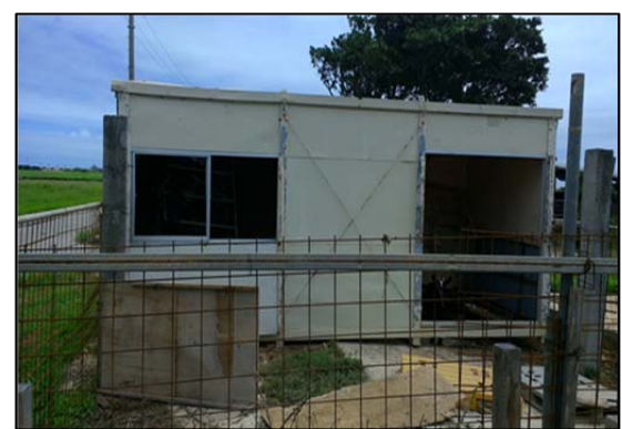
⑪-2 横転したコンテナ (復旧後)
