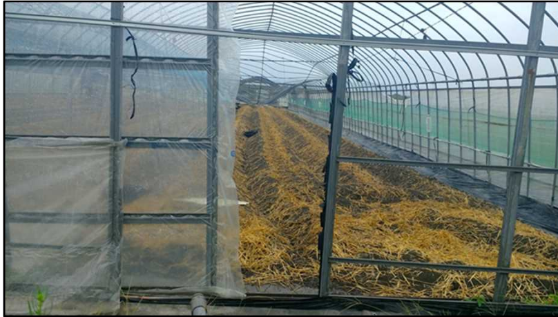
① - 1パイプハウスの変形や剥離
