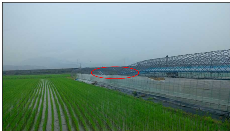
①-2パイプハウスの変形や剥離
