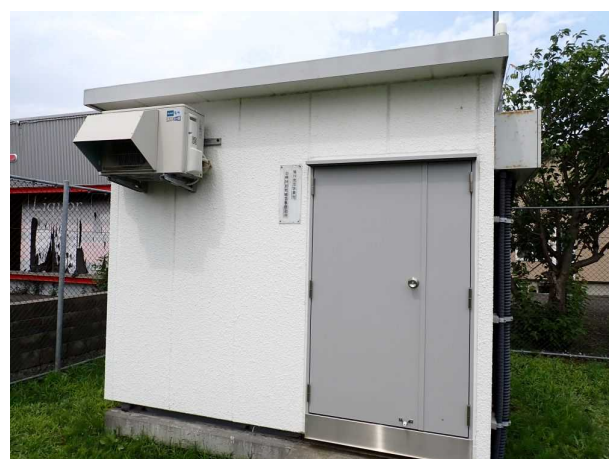
写真 4. 既存室外機①
