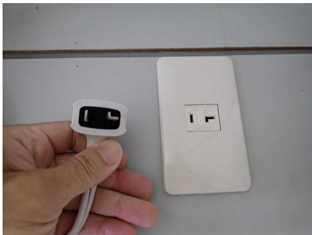
写真 3. 既存室内機用コンセント
