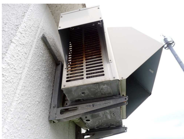
写真 6. 既存室外機③
