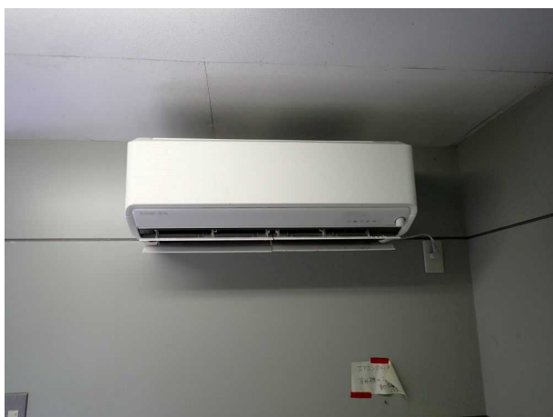
写真 1. 既存室内機①
