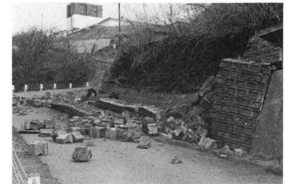
写真6.3.31 浦河測候所道路石垣の倒壊 札幌管区気象台, 1982
