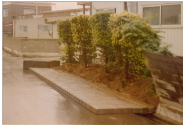
倒壊したブロック塀（石巻市）
