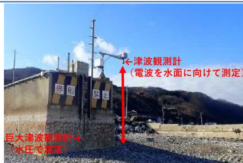
図10 隆起により観測不能となった気象庁津波観測点（珠洲市長橋）
