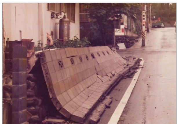
倒壊したブロック塀など (上/現仙台市宮城野区、下/現仙台市泉区) (気象台職員撮影)
