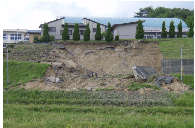
写真2. 栗原市鶯沢の法面崩落
