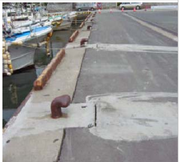
写真12 松川浦漁港岸壁の噴出痕
