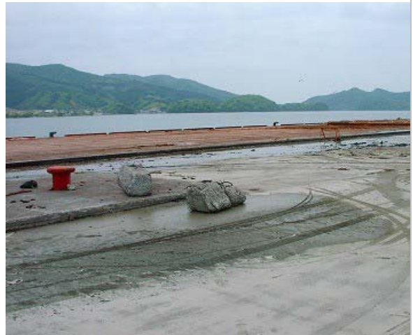
写真10 大船渡港の液状化現象の痕跡
