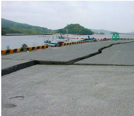
写真9 大船渡港岸壁の亀裂
