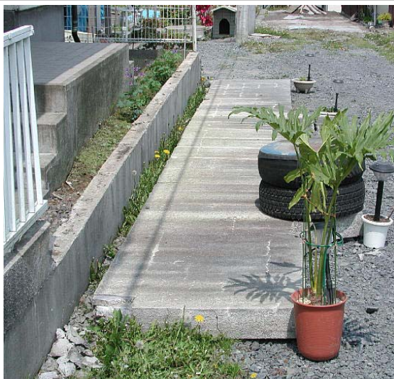
写真11 ブロック塀の倒壊
