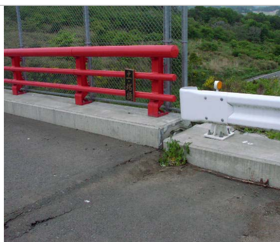
写真6 橋桁に 10cm 程度の段差
