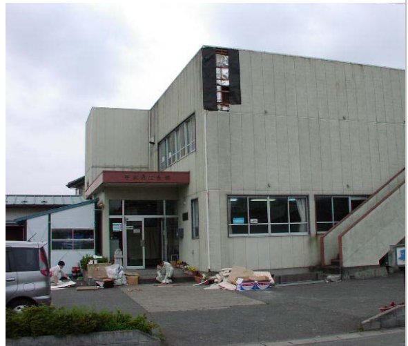
写真8 外壁の剥離・落下
