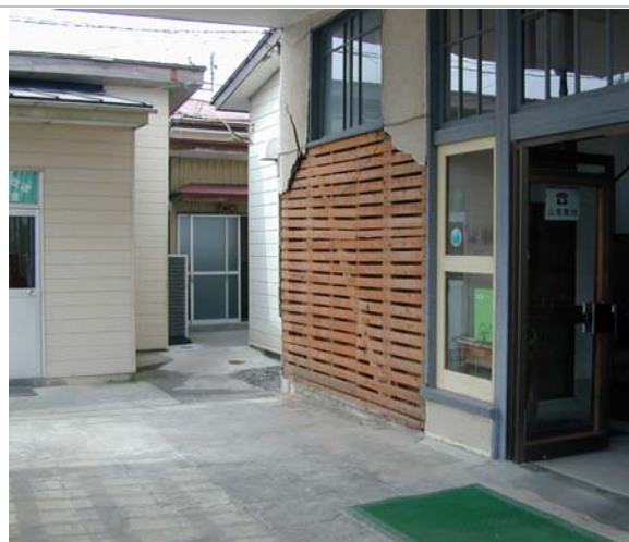
写真2 モルタルの剥離・落下
