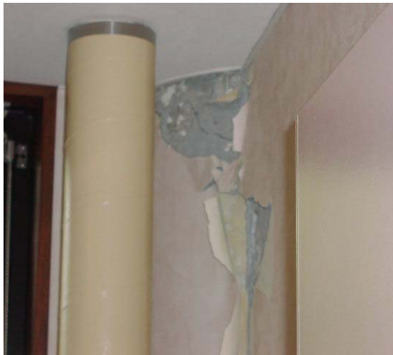
写真7 内壁の剥離・落下
