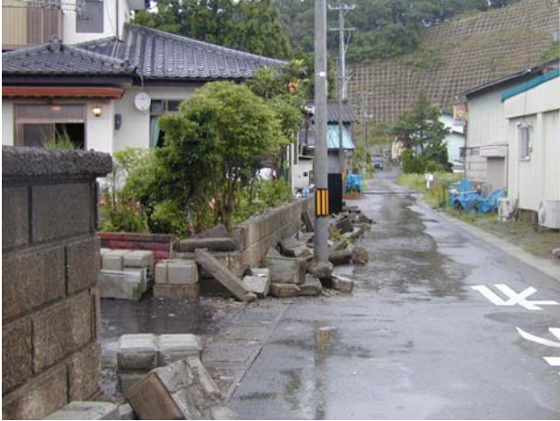
写真 13 鳴瀬町のブロック塀倒壊（鉄筋なし）
