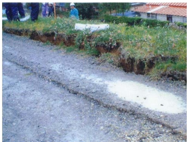
写真 18 南郷町 鳴瀬川近くの道路亀裂
