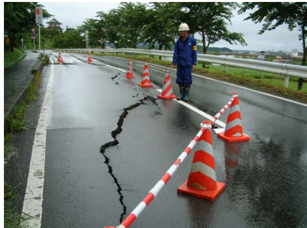
写真 16 涌谷町の県道の亀裂（長さ13mにわたる）
