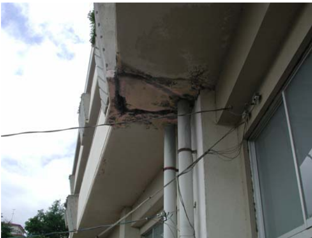
写真3 鹿島台町小学校舎の新旧継ぎ目部の破損
