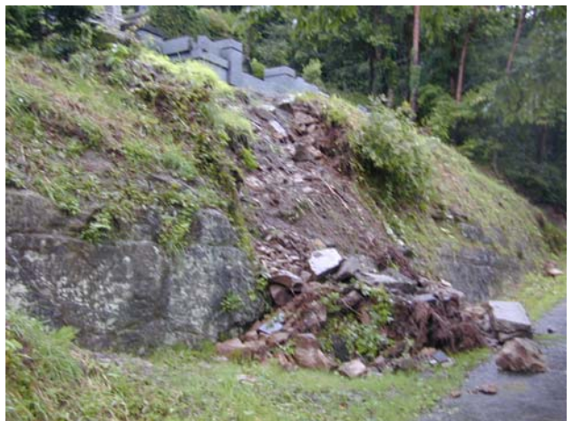
写真12 鳴瀬町の墓地下の崖崩れ
