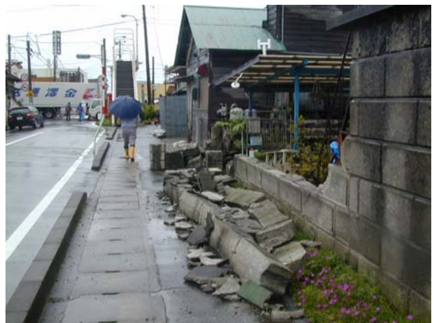
写真4 矢本町 ブロック塀の倒壊（鉄筋なし）
