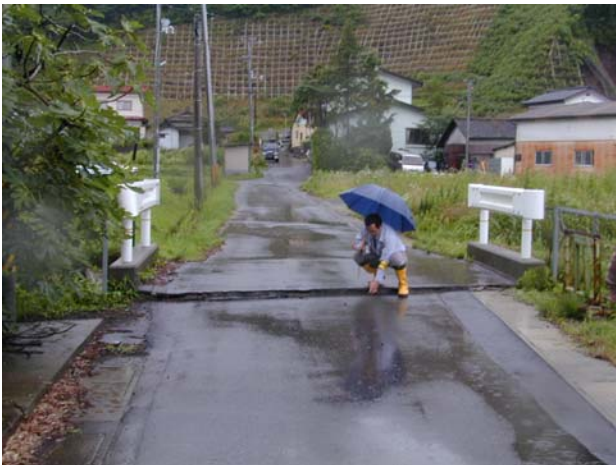
写真 15 鳴瀬町 道路と橋で10cmの段差ができている
