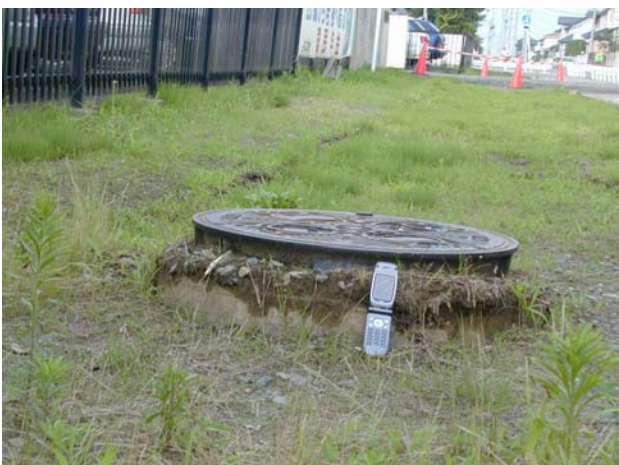
写真11 矢本町 保健相談センター前のマンホール (液状化により浮き上がったと見られる)
