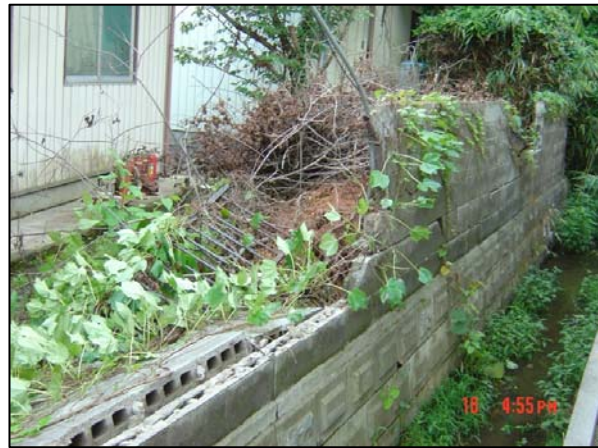
川崎町役場近くブロック塀の倒壊
