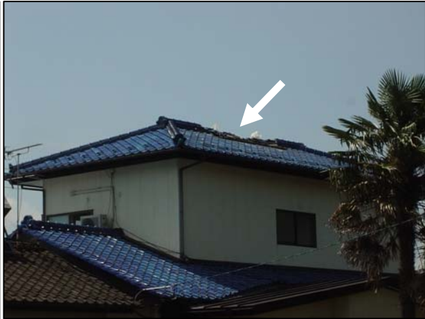
民家の屋根瓦の落下
