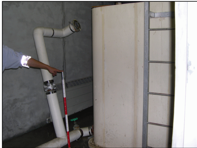
藤沢中学校タンクの破損
