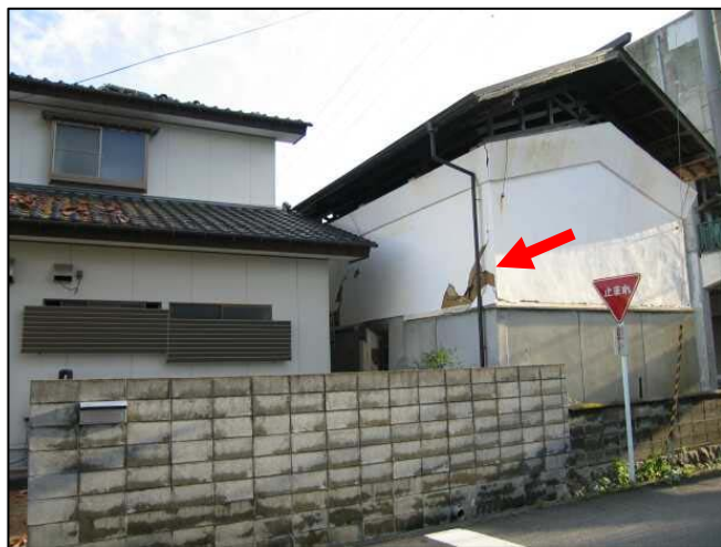
役場近く、民家の土蔵の壁破損
