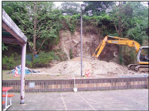
仙台市西公園がけ崩れ
