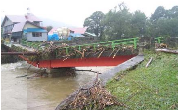
⑦河川増水による橋梁の倒壊(西和賀町)
