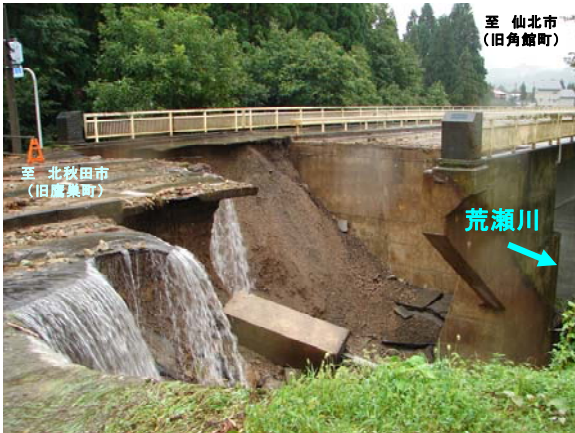
③崩落した国道 105 号（北秋田市） 写真提供：秋田県
