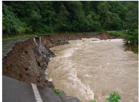
④崩落した小又川沿いの県道比内森吉線（北秋田市） 写真提供：秋田県
