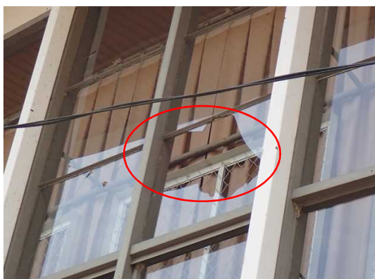
写真3-31 窓ガラスの落下（上：広域、下：狭域）
