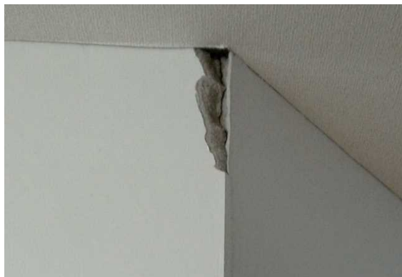
写真3-24 建物内壁の破損
