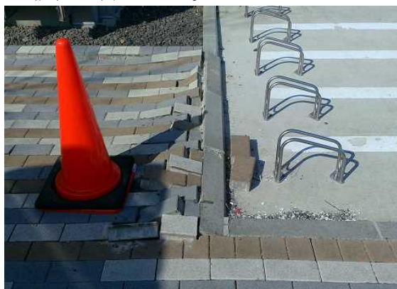
写真3-14 歩道インターロッキングのずれ
