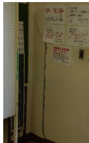
写真3-27 建物内壁の亀裂
