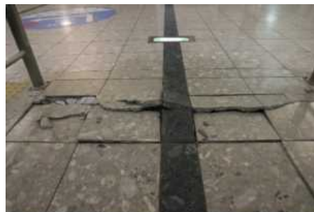
写真 3－9 床のタイルの割れ （仙台空港（株）撮影）
