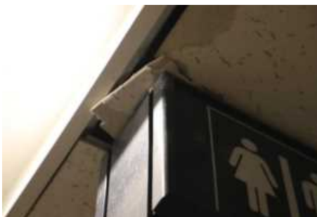
写真 3－10 天井パネルの剥離 （仙台空港（株）撮影）
