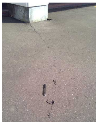
写真 3-1 庁舎入り口付近のアスファルト路面に亀裂
