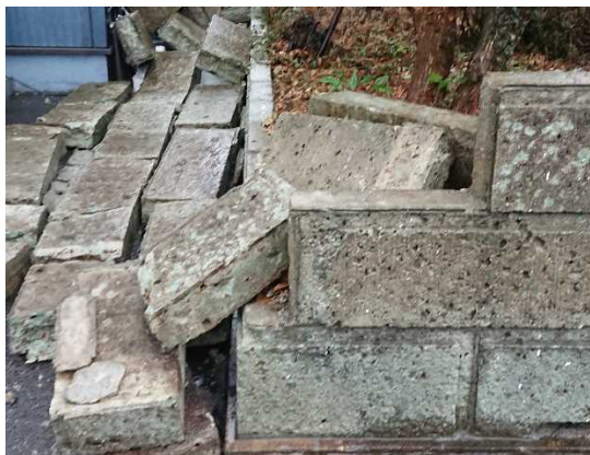
写真3-19 民家の塀の倒壊
