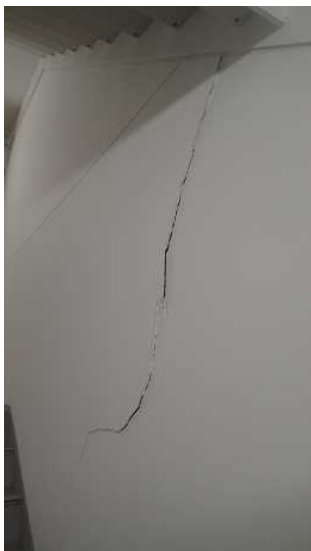
写真 3－8 階段の壁に亀裂
