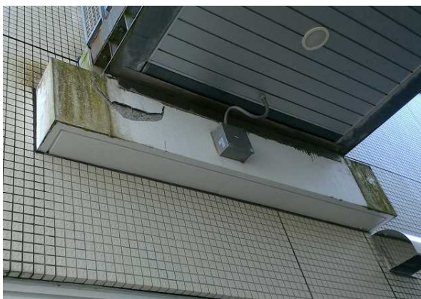
写真3-16 庁舎外壁のモルタル剥離
