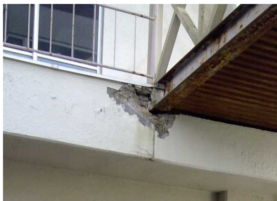
写真3-6 渡り廊下接合部の損壊
