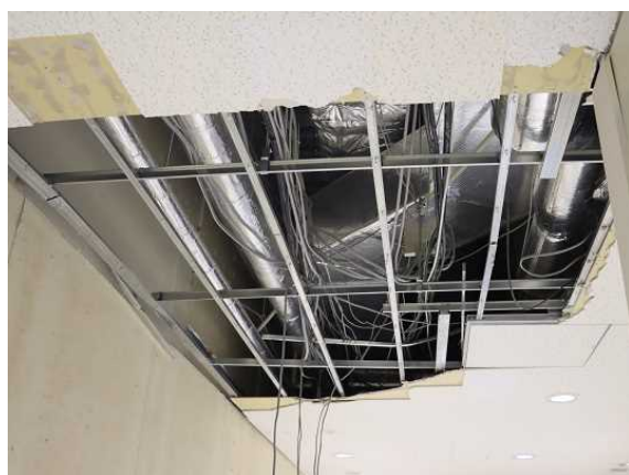
写真3-18 庁舎天井の破損 (落下)
