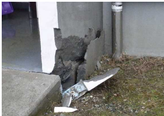
写真3-5 建物入口の壁の損壊
