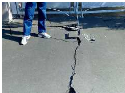
写真3-12 観測点周辺施設の門扉前の舗装割れ
