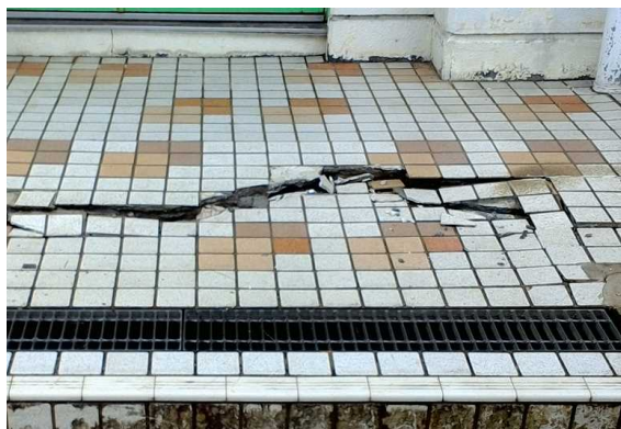
写真 3-3 建物玄関の床タイルの破損
