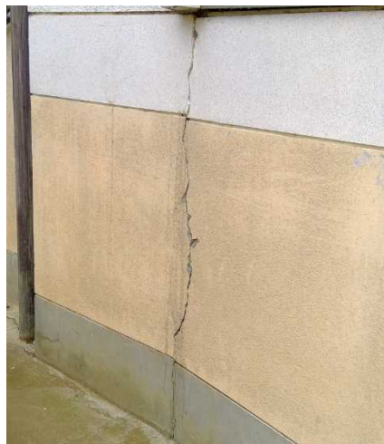
写真3-32 建物外壁の亀裂
