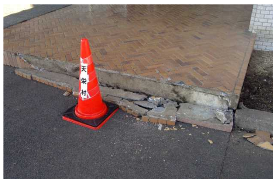
写真3-23 建物玄関段差部分の破損
