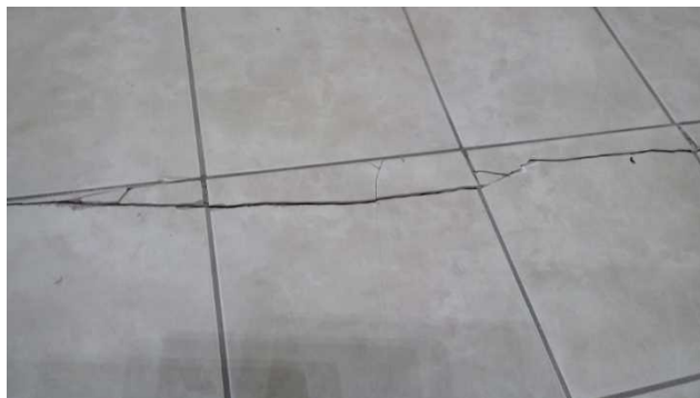
写真3-30 建物床材の亀裂
