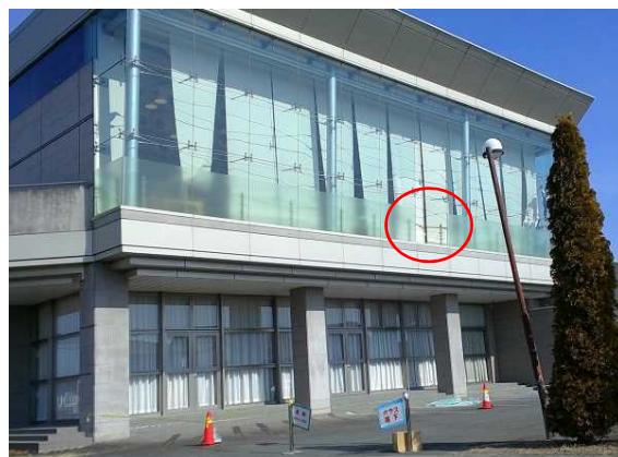
写真3-17 図書館のガラス製の柵の落下
