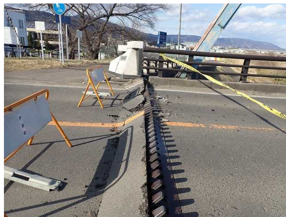
写真10：橋梁接合箇所の破損
