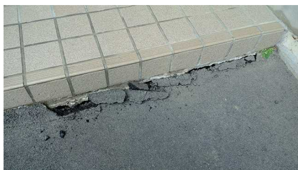
写真11：建物入り口の asphalt
