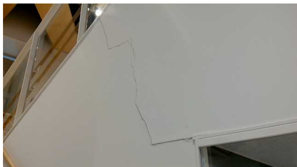
写真9：階段壁面ボードの亀裂
