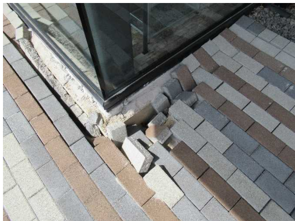
写真7：歩道ブロックの破損
