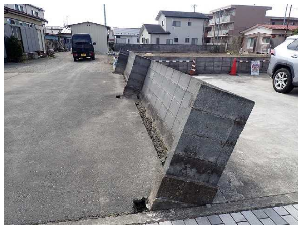
写真8：傾いたブロック塀
