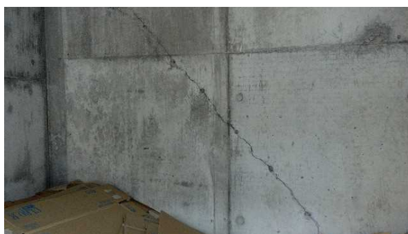
写真12：倉庫内コンクリート壁面の
