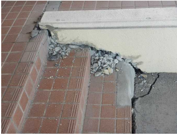
写真1：建物入口階段の破損
