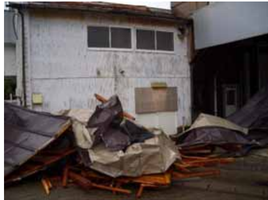
28_飛散した倉庫屋根拡大
