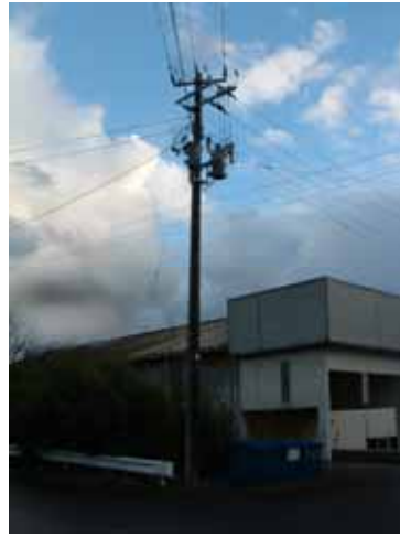
18_傾いた電柱（現在復旧済み） （撮影：北 南）
