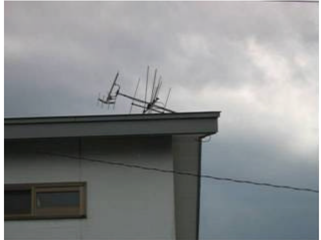
14_アンテナが東側に倒れる (撮影：北 南)
