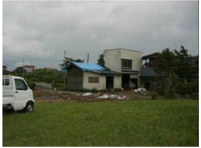
20_住家 C のトタン屋根が損壊 (撮影：南東 北西)
