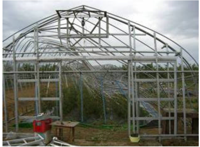
32_ビニールハウスの倒壊（南西側に倒れる） （撮影：東 西）
