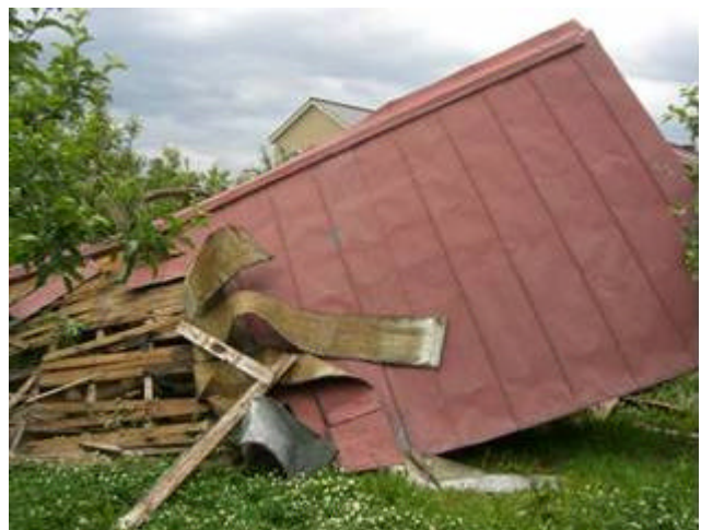
12_住家 B 裏側 (西側) の小屋が西側に倒壊 (撮影: 南西 北東)
