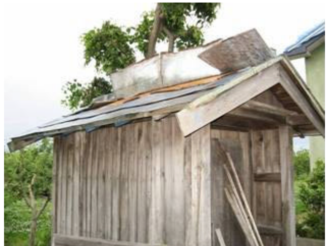
16_住家 B 南西側の小屋のトタン屋根が北側にめく れる(撮影：南東 北西)
