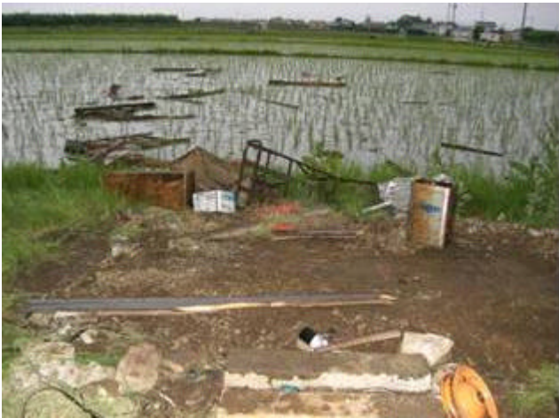
33_小屋が損壊し、北側に飛散 （撮影：南 北）
