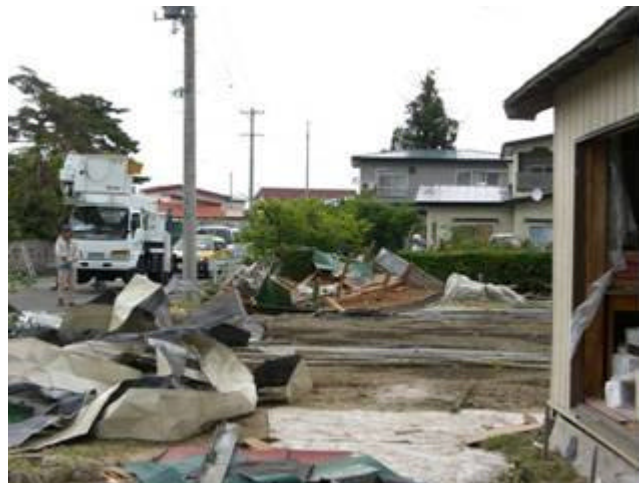
04_住家 A のトタン屋根が北側へ 16m 飛散 （撮影：南 北）
