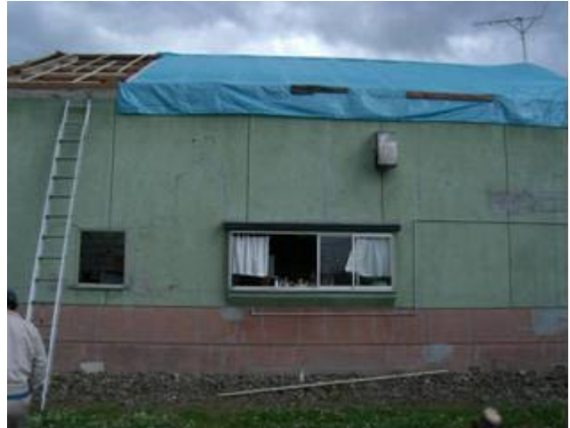
08_住家 B (裏側) のトタン屋根が損壊 (撮影: 西 東)
