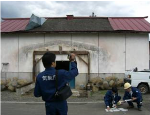
15_住家 B 南西側の小屋のトタン屋根が損壊 (撮影：北 南)
