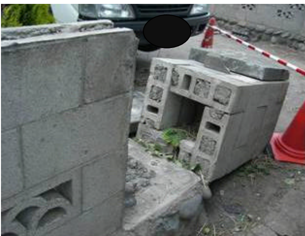
17_住家 D の門柱が北側へ横転 (撮影：南東 北西)
