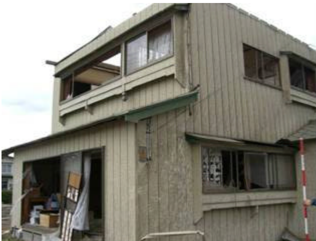
03_住家 A（南西側の壁面に泥の汚れ） （撮影：南西 北東）
