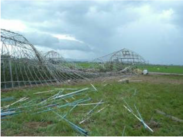
31_ビニールハウスの倒壊（北東側に倒れる） （撮影：南西 北東）
