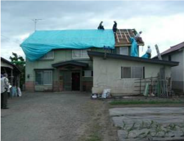
07_住家 B (正面) のトタン屋根が損壊 (撮影: 東 西)
