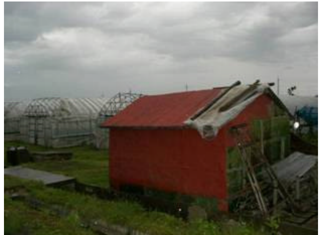
34_北東側を損壊した小屋の屋根とビニールハウス （撮影：南西 北東）
