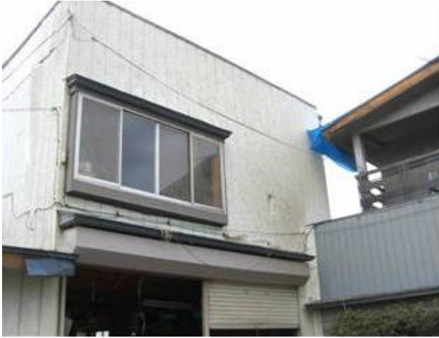
19_住家 C の南東側の壁面に泥が付着 (撮影：南東 北西)
