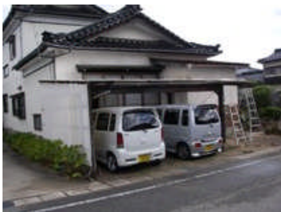
写真 01 屋根が一部破損した車庫、向かって右側は全壊した簡易車庫跡（民家 1） （遊佐町役場撮影）
