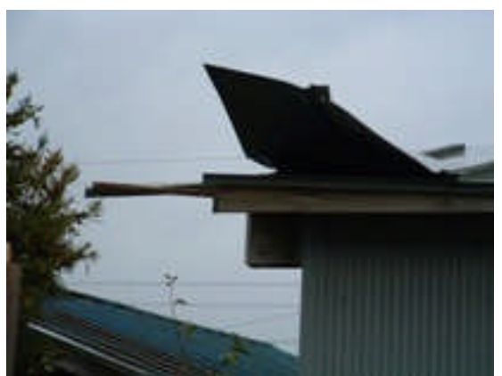
写真 12 倒壊した車庫に隣接する倉庫の屋根トタンが一部剥離 (気象庁機動調査班撮影)
