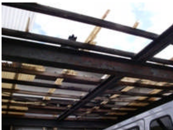
写真 02 破損した車庫の屋根（民家 1） （遊佐町役場撮影）
