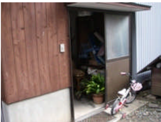
写真 15 車庫西側のサッシガラスが破損し内側にいた幼児 1 名けが（民家 5 所有） （遊佐町役場撮影）
