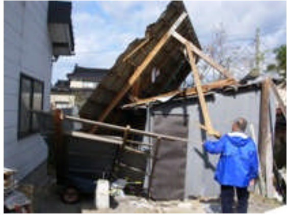
写真 10 基礎の一部が破損し倒壊した木造車庫 (民家 3) (遊佐町役場撮影)
