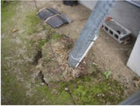
写真 07 民家 2 の引き込み柱根元 (遊佐町役場撮影)
