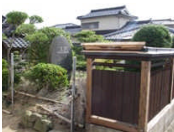
写真 04 民家 1 の簡易車庫が衝突した塀 （遊佐町役場撮影）
