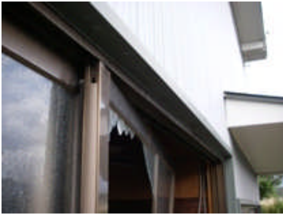
写真 14 車庫南側のサッシ戸が内側にめり込んでガラス破損（民家 4 所有） （遊佐町役場撮影）
