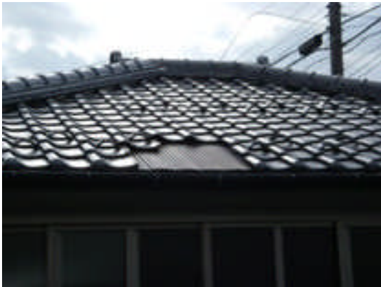
写真 08 民家 2 の南西側車庫の屋根瓦落下 (遊佐町役場撮影)
