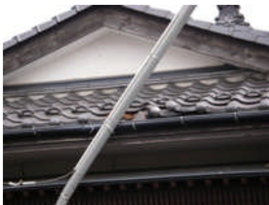
写真 06 民家 2 の引き込み柱と屋根の接触 （遊佐町役場撮影）
