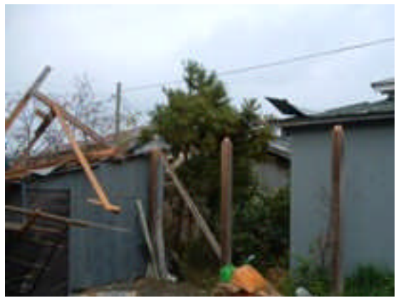
写真 11 基礎の一部が破損し倒壊した木造車庫 (民家 3) (気象庁機動調査班撮影)
