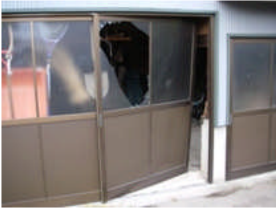
写真 13 車庫南側のサッシ戸が内側にめり込んでガラス破損（民家 4 所有） （遊佐町役場撮影）
