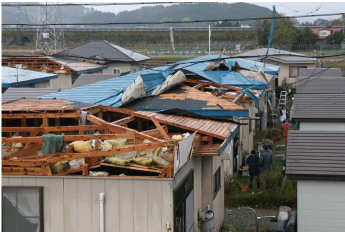
② 屋根の損壊 (西側から撮影)
