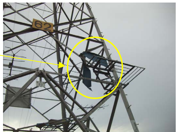
⑦ 送電線鉄塔の飛散物 (鉄塔南側から撮影)
