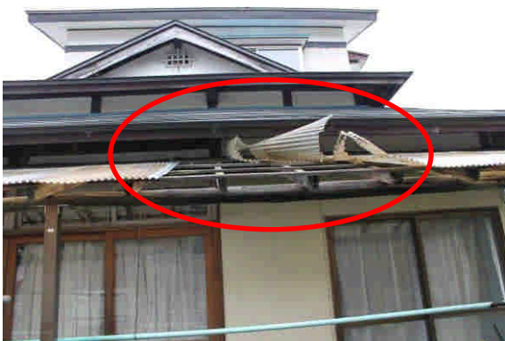
写真P 聞き取り調査⑩の住宅南側のひさしの一部破損（写真提供；盛岡西消防署）
