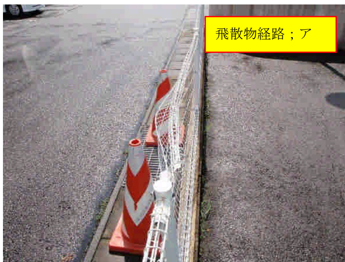
写真 B 飛散物によって破損した県営青山アパートフェンス（東→西方向を撮影）
