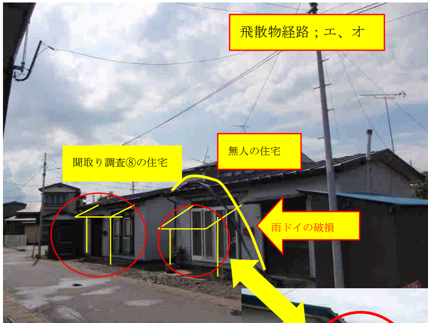
写真 K 被災した住宅 聞取り調査⑧の隣家は無人 ひさし及び雨ドイ破損
