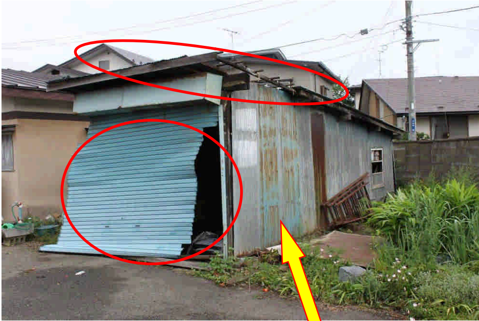
写真N 物置小屋の屋根及び出入口 シャッター破損（写真提供；盛岡西消防署） 屋根の飛散先は不明
