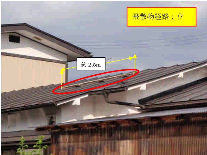
写真 D 屋根に角材が飛んで来た。形状から、飛散物は南西方向に直線距離で約 50m 離れた場所で被災した何れかの住宅の、ひさしの一部と思われる
