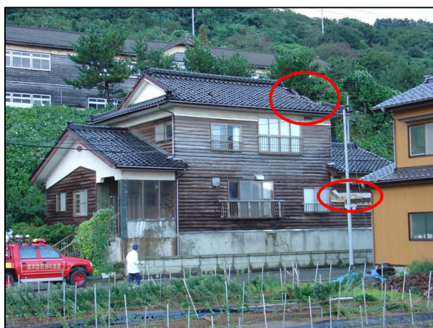
【写真 01】住家北西側の壁及び南西側の瓦破損 （①地点）（鶴岡市温海庁舎総務課提供）
