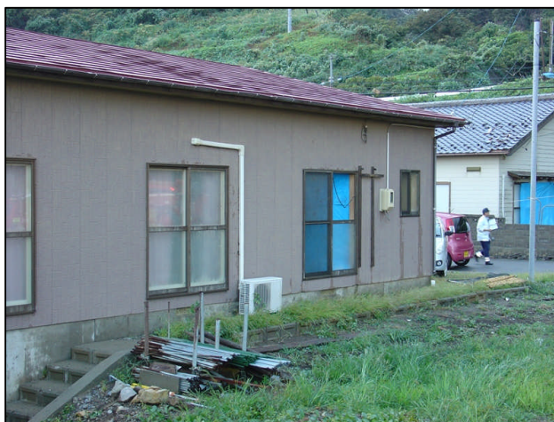
【写真 08】 南側の窓ガラス破損 (④地点) (鶴岡市温海庁舎総務課提供)
