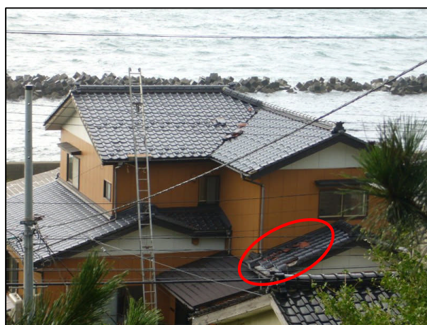
【写真 04】住家東側の瓦一部破損（②地点）
