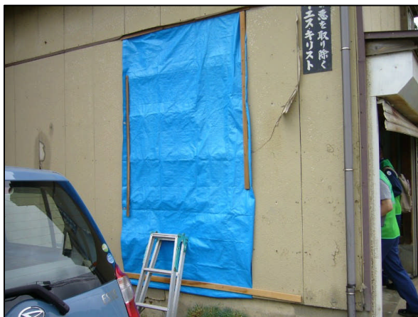
【写真 09】 車庫南側の壁破損 (⑤地点)
