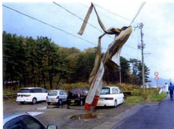
⑥折板屋根が国道を越え電線に引っ掛かる (撮影：北→南 深浦町提供)
