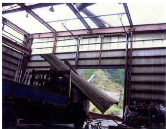
③鉄工所内部の状況 落下した折板屋根 (撮影：鉄工所内部→東正面側 深浦町提供)
