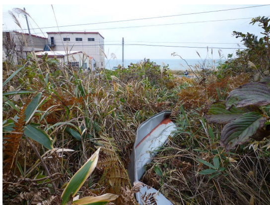
⑦折板屋根が北東方向へ飛散 (撮影：北東→南西)
