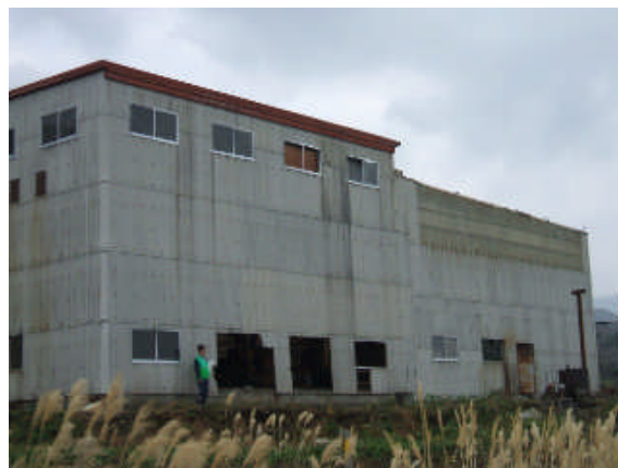
②鉄工所西側 窓枠や壁の一部が破損 (撮影：北西→南東)
