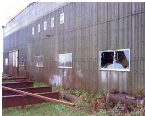
④鉄工所南側 破損した窓ガラス (撮影：南東→北西 深浦町提供)
