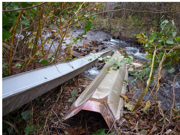
⑧折板屋根が東南東方向へ飛散 (撮影：北西→南東)
