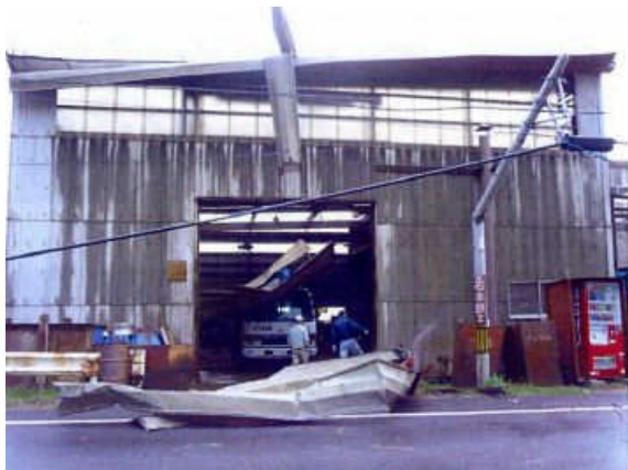
⑤折板屋根が鉄工所前に落下、折板屋根が電線に引っ掛かり 電信柱が折損 (撮影：東→西 深浦町提供)
