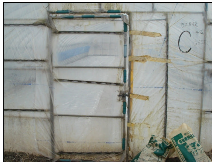
4. 被害ビニールハウスA(北側) 当日も扉は閉められていたが、隙間はある
