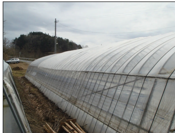
2. 被害ビニールハウスA(東側) 補修されてビニールが2重になっている部分が見える
