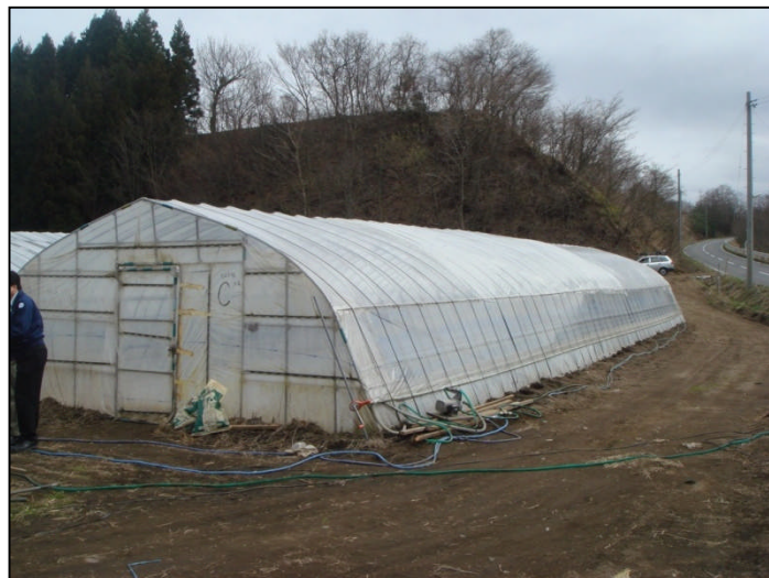
1. 被害ビニールハウスA(西側) 補修されてビニールが2重になっている部分が見える
