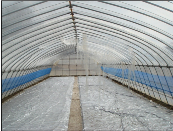
9. 被害ビニールハウスAの内部 破損したビニールが垂れ下がっている 北から南方向に撮影
