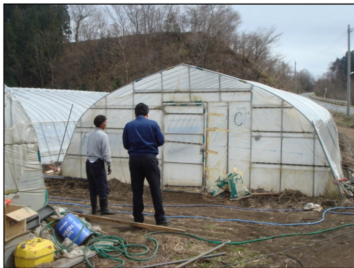
3. 被害ビニールハウスA(北側) 当日は扉は閉められていた
