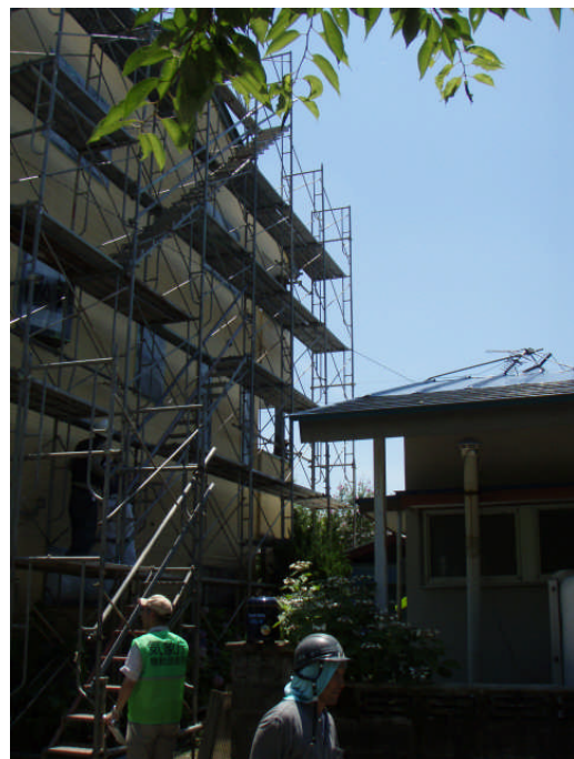
⑩ 足場が一部倒れて屋根に落ちて屋根の一部 とアンテナが破損。（北側から撮影）
