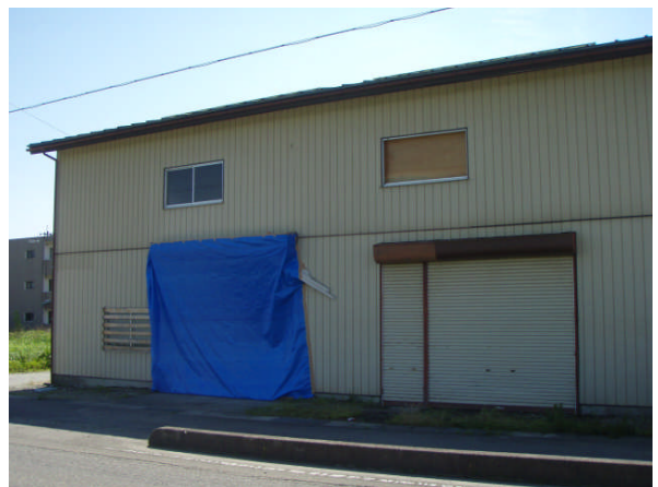
⑥ 車庫のシャッターが突風により被害があった。 (北東側から撮影)
