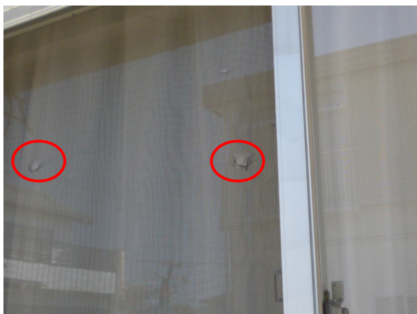
⑥ 飛散物により西側の網戸の一部が破損（南西側から撮影）
