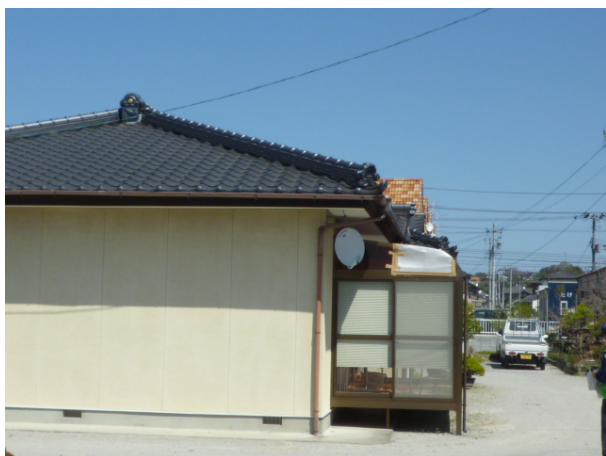
⑧ 飛散物によりサンルームの一部が破損（西側から撮影）
