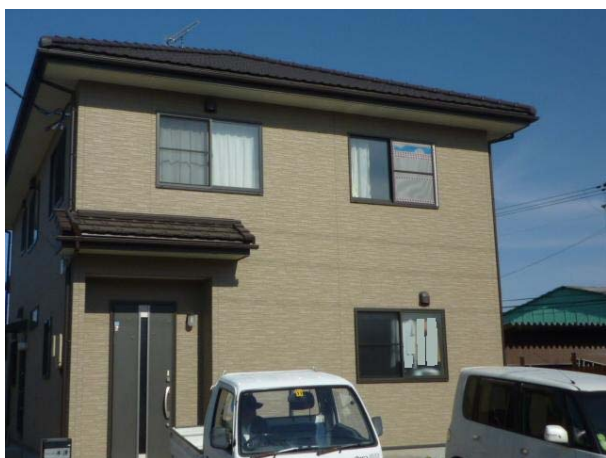
④ 飛散物により二階の窓のガラスが破損（ビニールで補修済み）（北西側から撮影）
