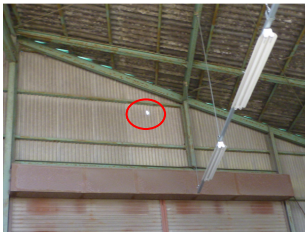
⑦ 飛散物により壁の一部が破損（南側から撮影）
