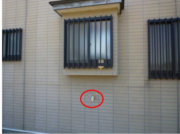
② 飛散物により北側窓ガラスが破損。飛散物が壁に突き刺さる（北側から撮影）
