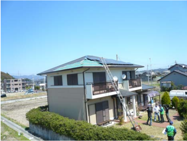
① 屋根と太陽光パネルの一部が破損（南西側から撮影）
