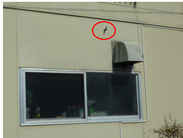
⑤ 飛散物が壁に突き刺さる（北西側から撮影）
