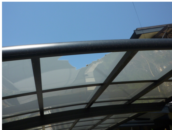
⑨ 飛散物により車庫の屋根が破損（南側から撮影）
