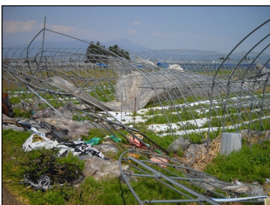
⑤ 倒壊したビニールハウス（西から撮影）
