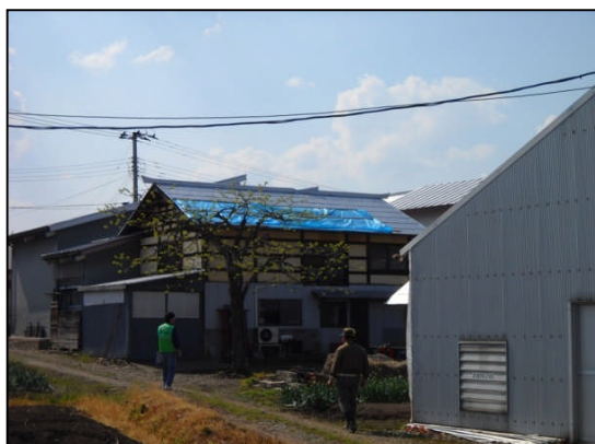
① 非住家の東側トタン屋根剥離し、50m離れた北西の民家へ飛んだ（東から撮影）
