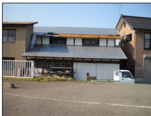
② 住家南側のトタン屋根剥離（南から撮影）
