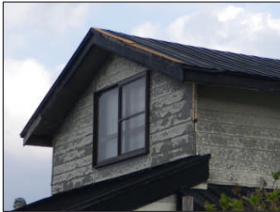
A 屋根のトタンがめくれ(調査時には修復済み) 破風部が剥離した住家 (西から撮影: 深浦町役場提供)
