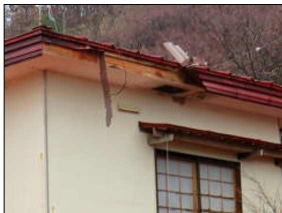
E 屋根の破風部が剥離した住家 (北西から撮影)
