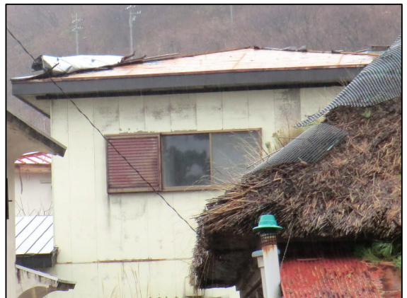
D 屋根のトタンがめくれ、飛散した 住家 (南西から撮影)
