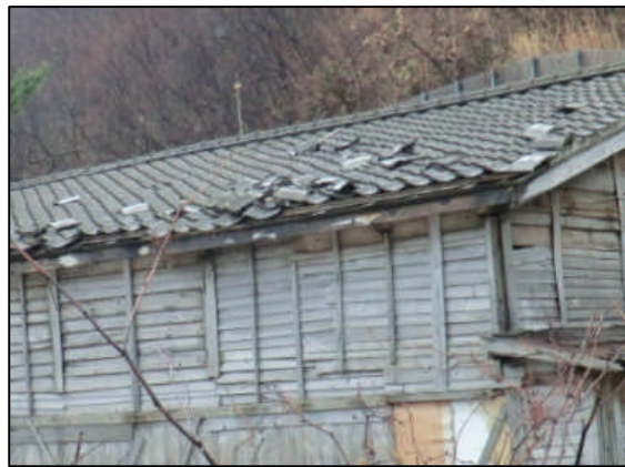
C 屋根瓦がめくれ、一部が落下した 非住家 (北西から撮影)
