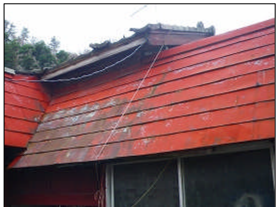
F 屋根瓦がめくれ、一部が落下した 非住家 (北西から撮影: 深浦町役場提供)
