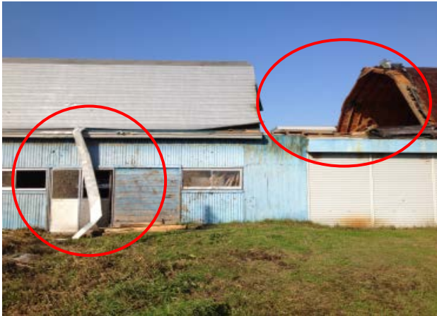
①屋根の一部が飛散し（右）トタンが西側に剥離した（左）非住家（牛舎）（南から撮影）
