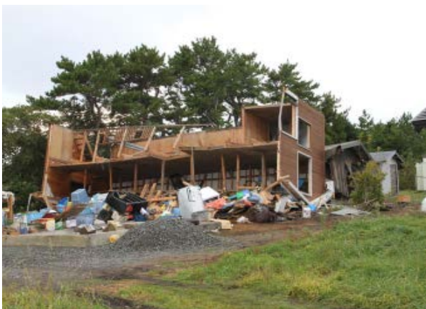
⑤北側に倒壊した非住家（作業小屋） （東通村役場提供：南東から撮影）
