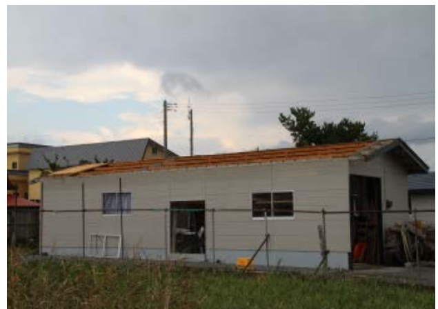
⑥屋根南面のトタンが飛散した非住家（作業小屋） （東通村役場提供：南東から撮影）
