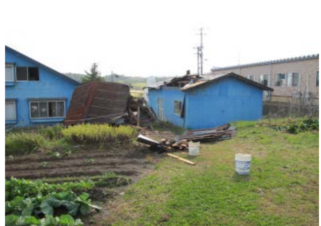
②北側に全壊した非住家（左の物置小屋）と全壊した非住家（右の作業小屋）（北東から撮影）
