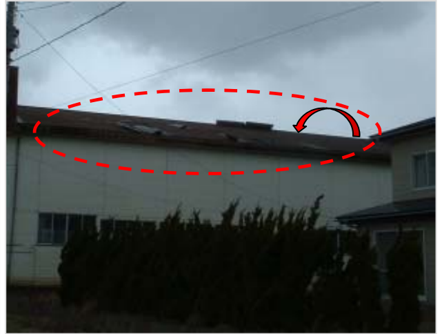
② 屋根のトタンがめくれた非住家 (南東から撮影)
