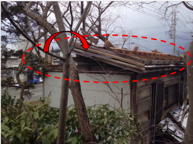
① 屋根の一部が剥離した小屋 (北東から撮影)
