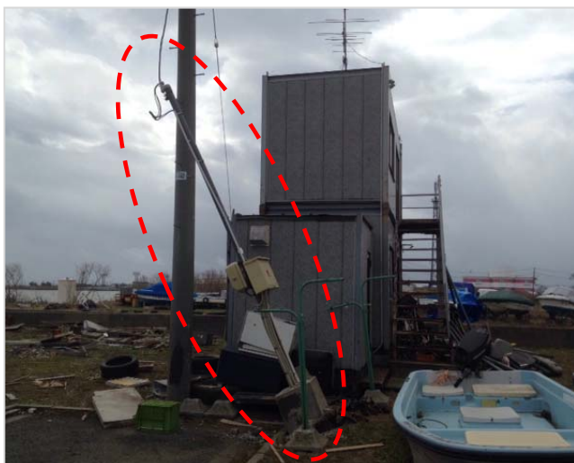
⑤ 東北東に傾いた引込柱 (北から撮影)
