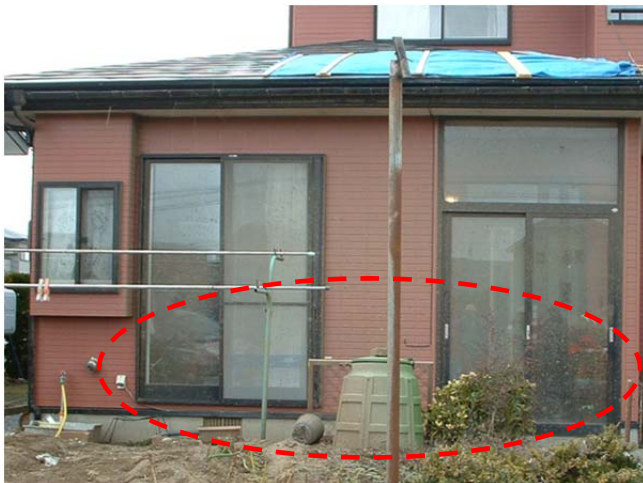
③ 屋根のトタンがめくれた住家 (南から撮影:壁面・窓ガラスに泥が付着)
