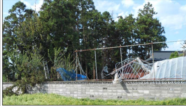
②変形したパイプハウス（南から撮影）
