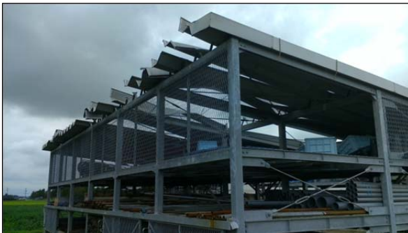
⑤屋根が飛散した資材倉庫（南西から撮影）
