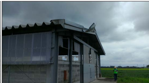
⑥庇と樹脂製波板パネルが破損した倉庫 （屋根と壁面の間に開口部あり） （北西から撮影）
