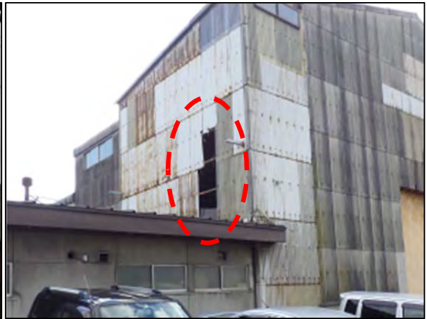
② 東面の外壁が破損した工場 (北東から撮影)
