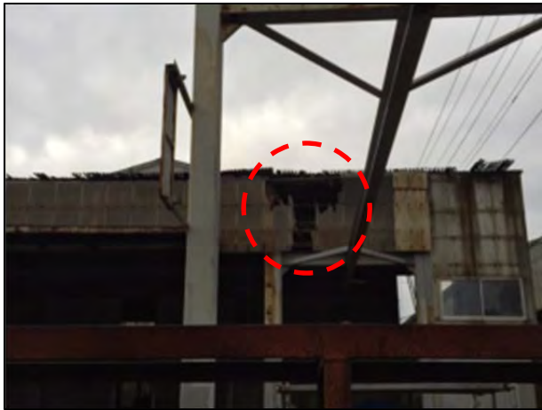
① 西面の外壁が破損した工場 (西から撮影)
