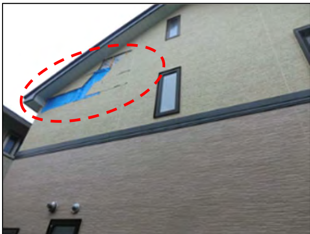
⑤ 北側の外壁が破損した住家 (北から撮影)
