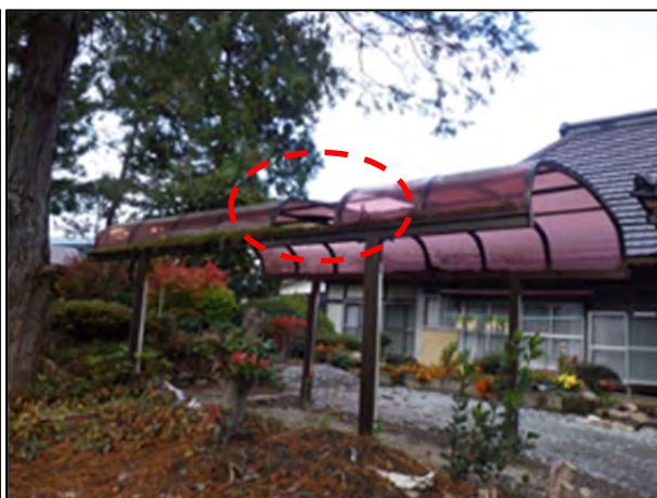
② 飛来物により屋根パネルが破損した カーポート(南東から撮影)
