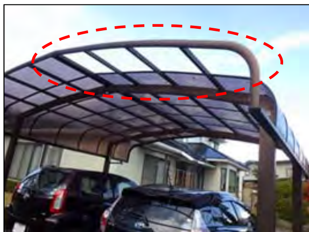
① 屋根パネルが破損したカーポート (南から撮影)
