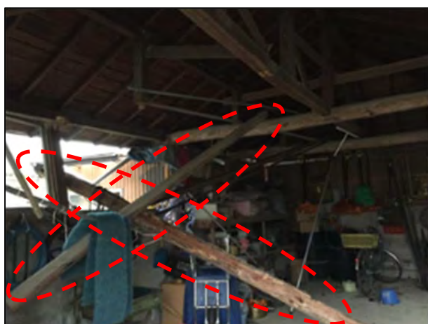
⑤ 屋根が破損し、梁が落下した作業小屋 (西南西から撮影)
