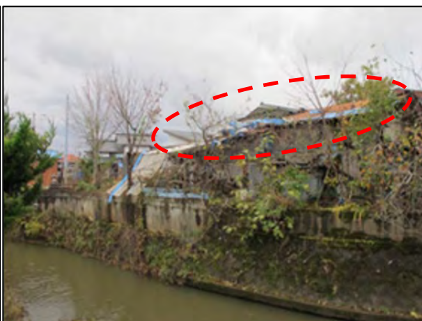
④ 屋根のトタンがはく離した倉庫 (西北西から撮影)
