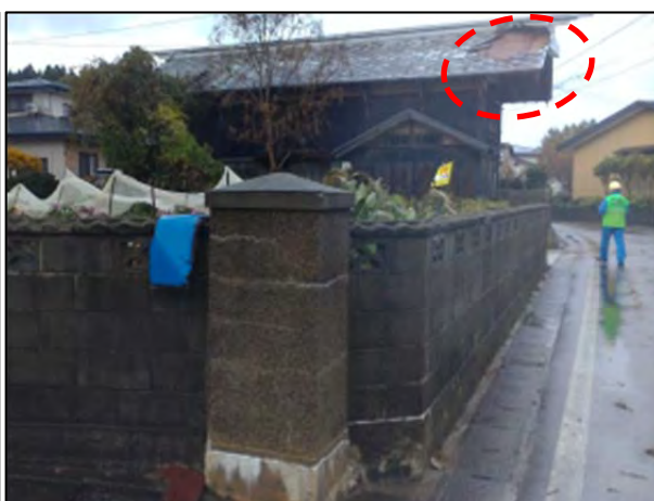
⑥ 屋根のトタンがはく離した蔵 (西南西から撮影)
