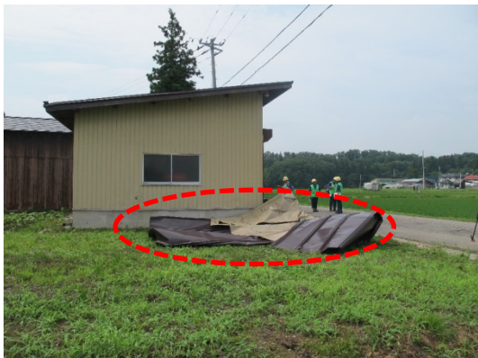
①トタン屋根が飛散した非住家 (破線：電線から下ろしたトタン屋根)
