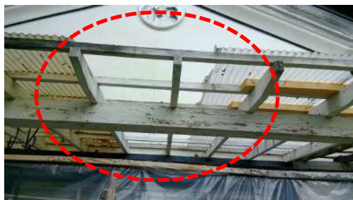
③木造非住家の庇の破損
