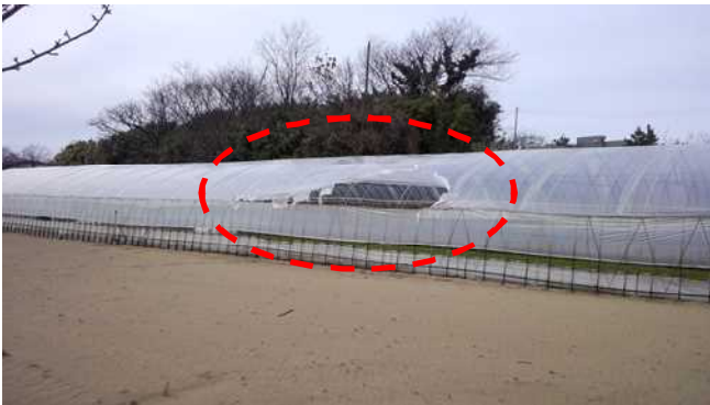
パイプハウスの被膜材のはく離(南側から撮影)
