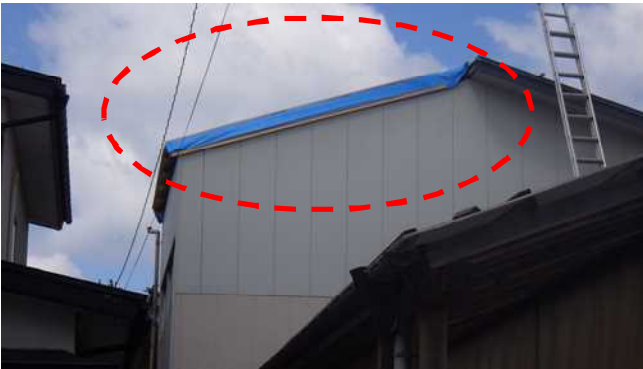
屋根の野地板が南東へ飛散した木造住宅 (東側から撮影)
