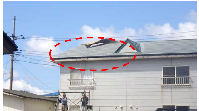
の屋根が飛散し屋根を破損した集合住宅 (東側から撮影)
