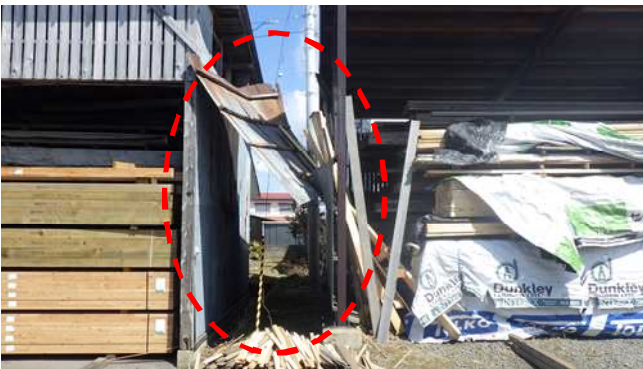
壁材がはく離(南側から撮影)
