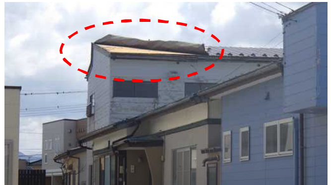
屋根ふき材がはく離した非住家(西側から撮影)
