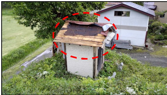
古い祠の屋根ふき材はく離(南から撮影)
