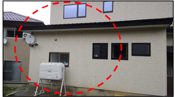
壁に草が付着(南西から撮影)
