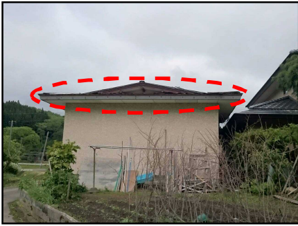
-1 住家の屋根ふき材はく離 (南西から撮影)
