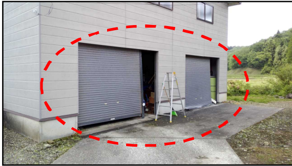
車庫のシャッター破損
