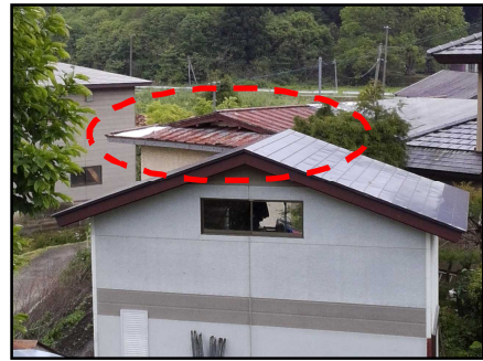
-2 住家の屋根ふき材はく離 (南から撮影)
