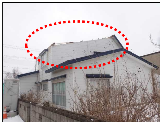
② 屋根の野地板が破損、飛散した2階建て木造住宅(北西から撮影)
