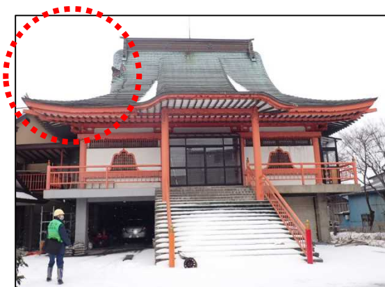
① 屋根の一部が剥離した寺の本堂 (南東から撮影)
