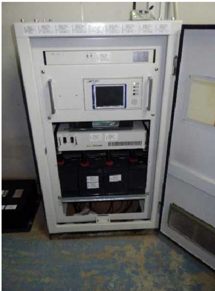
震度計処理部
