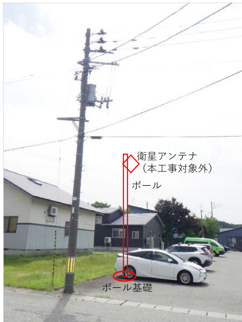
電柱2 H11m (あけぼの線 4南7東5北2)
