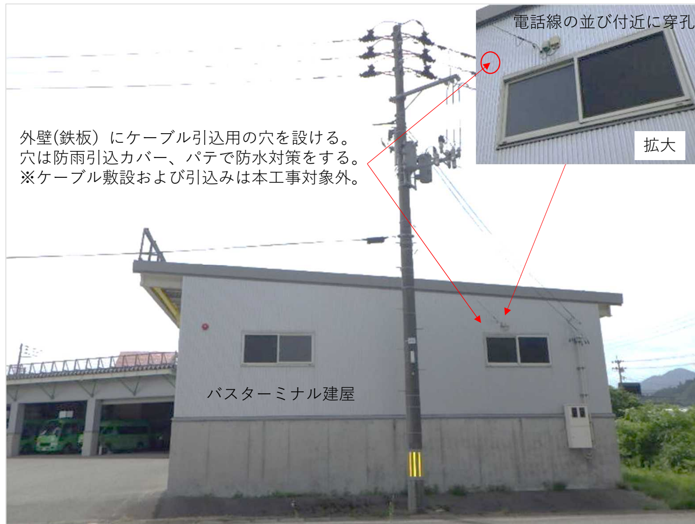
電柱1 H11m (あけぼの線 4南7東5北1)
