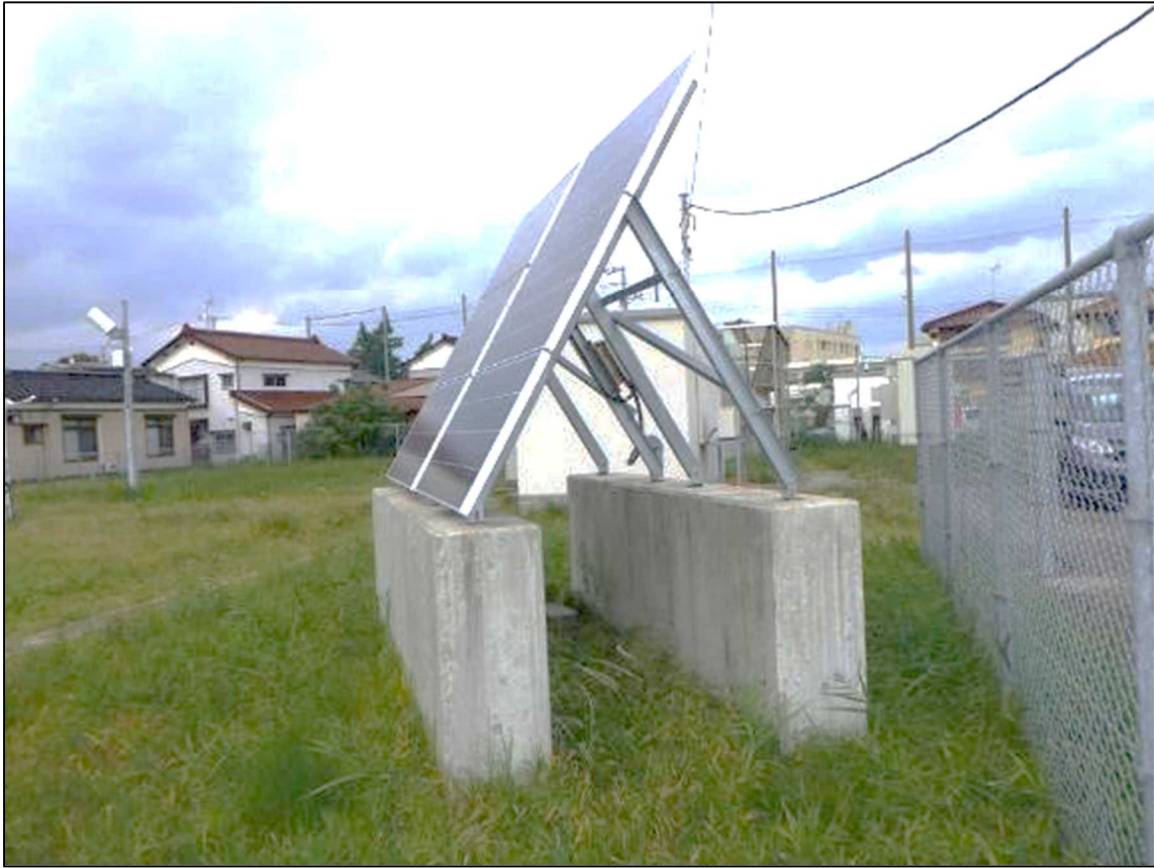
太陽光パネル（側面/東側）
