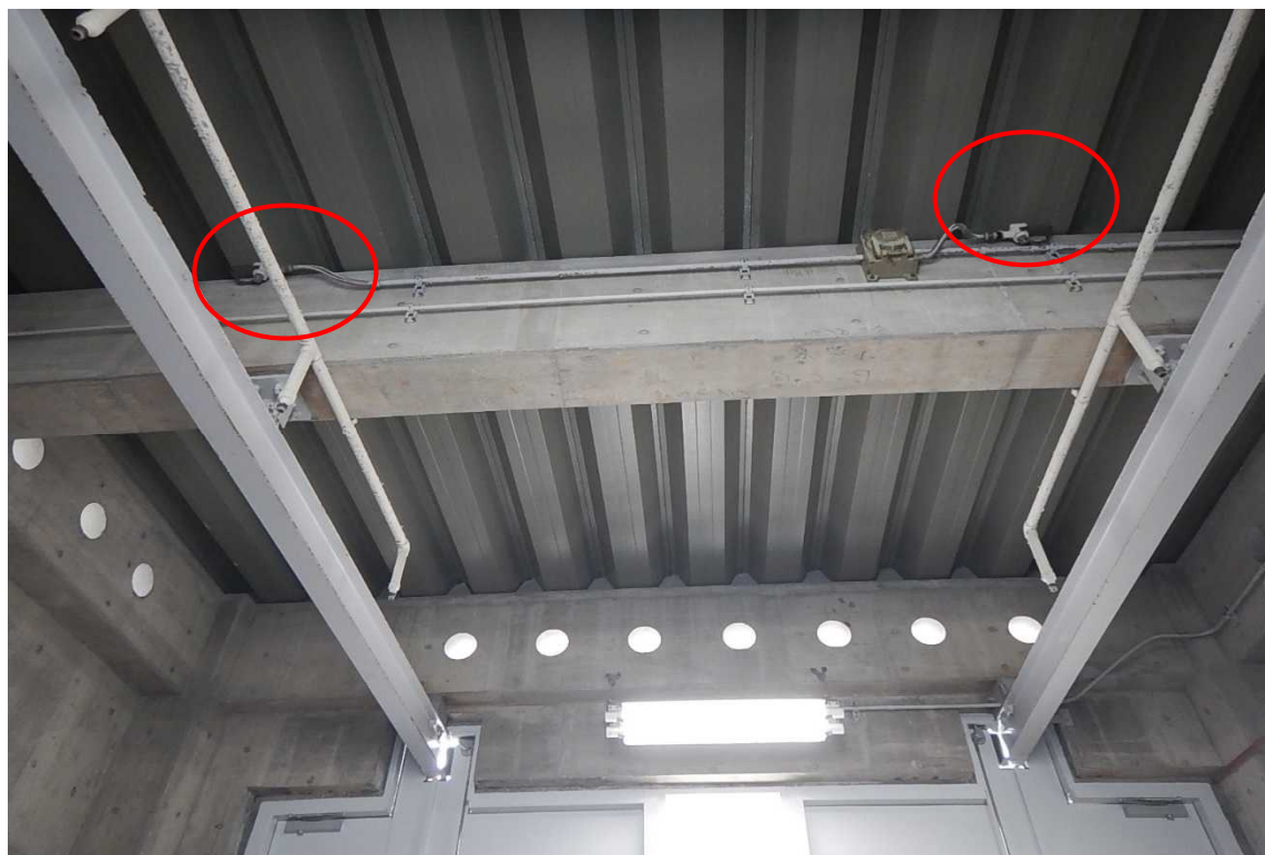
図 3 気球棟拡散式ガス検知部（貯蔵室）
